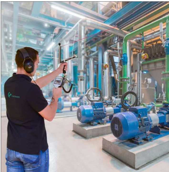
Localización puntual de fugas durante la operación con puntero láser y cámara integrada
